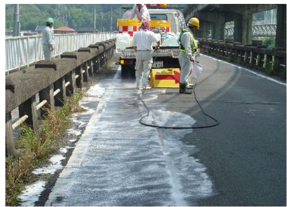
国道2号線に流出した油を1キロm高圧洗浄
